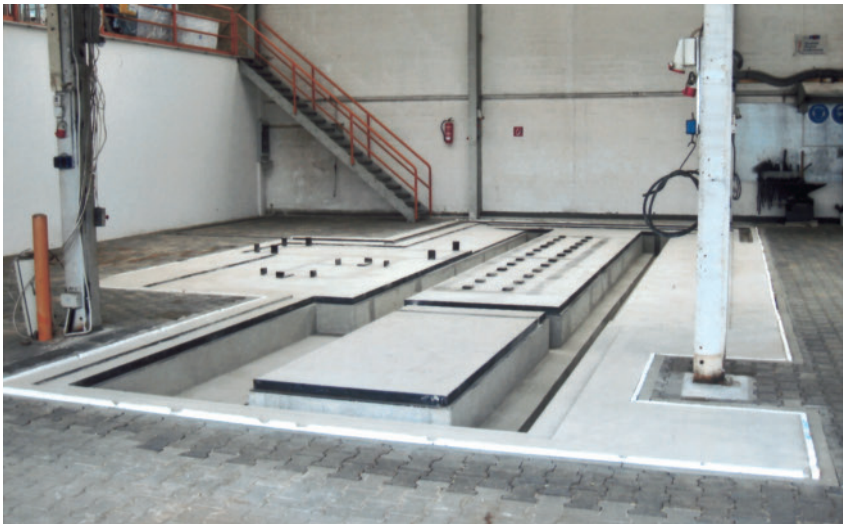
3 Die Basis für Präzision: Die 4+2-Achs-Bettfräsmaschine von Sachman erhielt bei HSR Speckhahn ein solides Fundament. In der Praxis schaffen es die Radenbecker, die vom Hersteller angegebenen Bearbeitungsgenauigkeiten noch zu übertreffen
